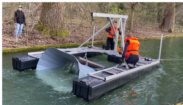
Рис.2. Общий вид пико-турбины на понтонной основе.
