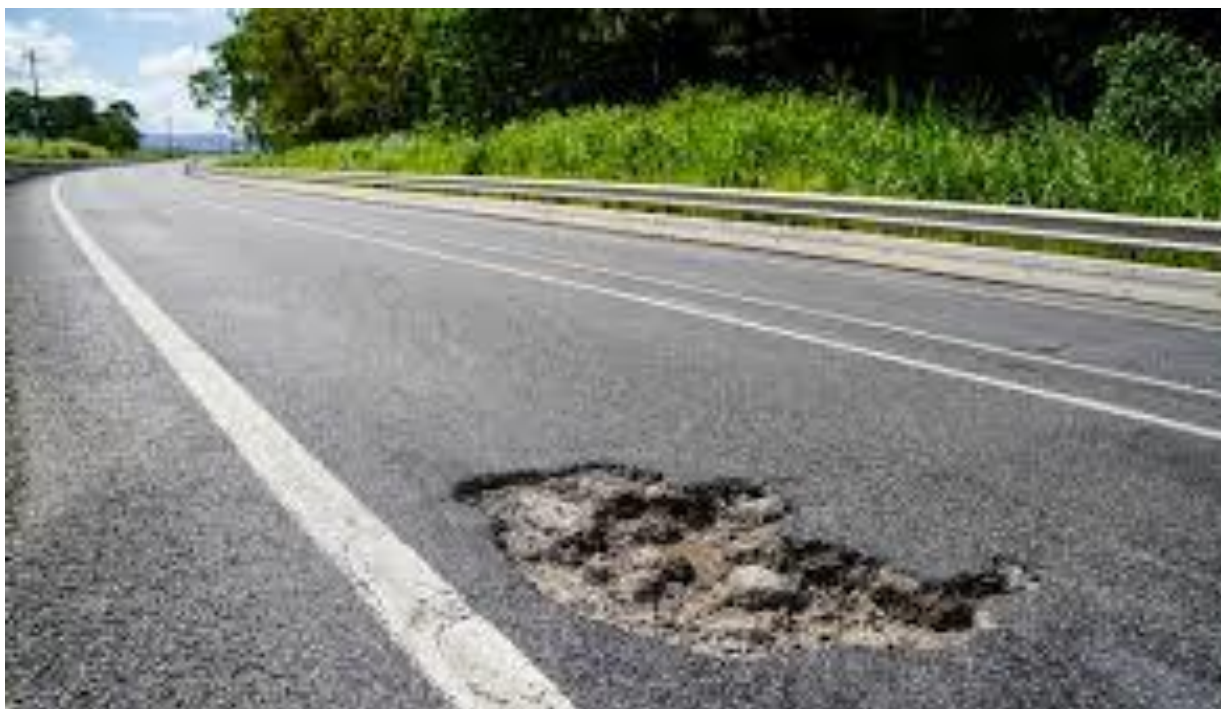
Рисунок-1. Разрушение структурных слоев дорожных покрытий
