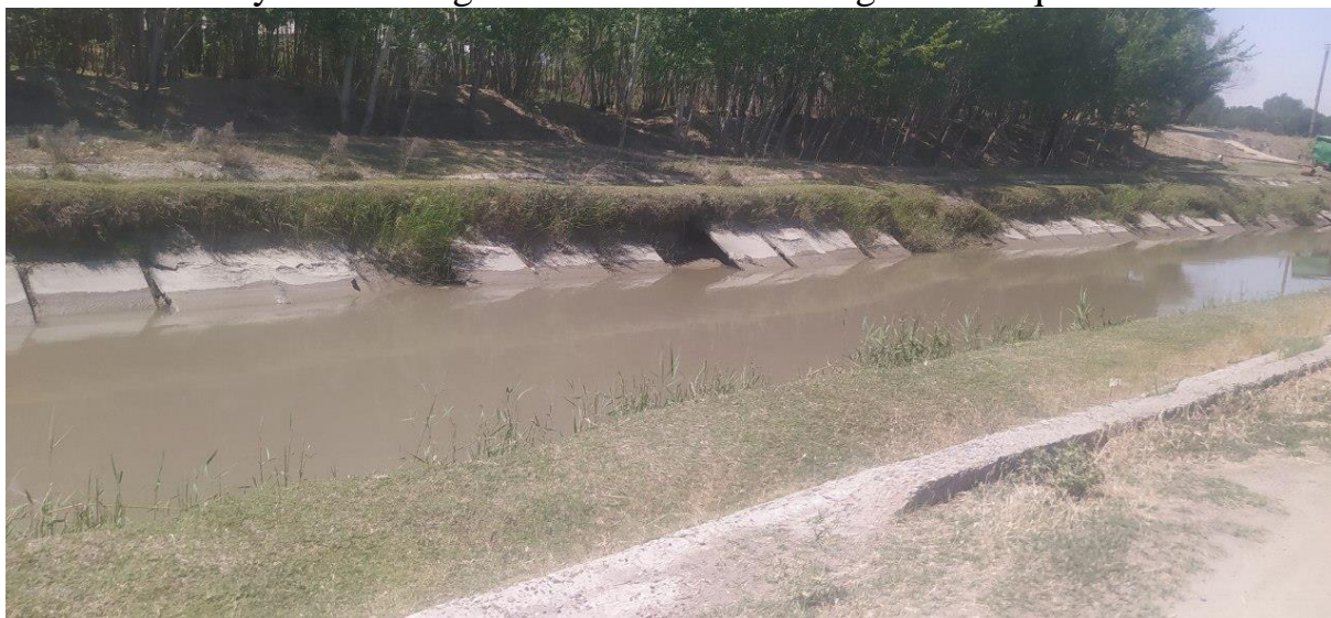
1-rasm Kanal beton qoplamasini buzilish holatlari
