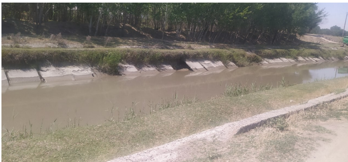
1-rasm Kanal beton qoplamasini buzilish holatlari
